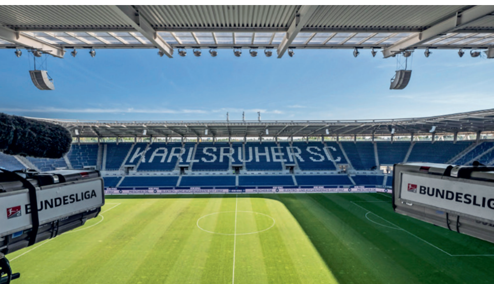
Installiertes Beschallungssystem L-Acoustics im Wildparkstadion, Karlsruhe.
