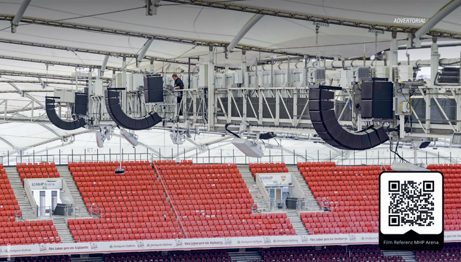
Installiertes Beschallungssystem RCF/TT+ Audio in der MHP Arena, Stuttgart.
